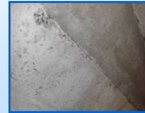
コンクリートのはくり
