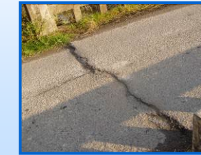
橋面舗装の異常
