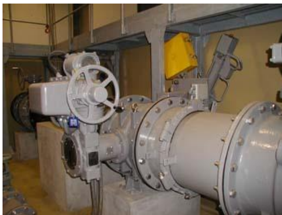
日野配水池に設置されている 緊急遮断弁
