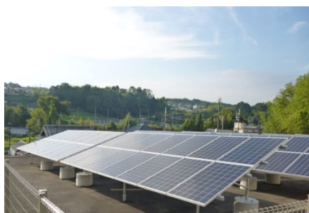
水道施設である日野加圧ポンプ室敷地内に設置した太陽光パネル
