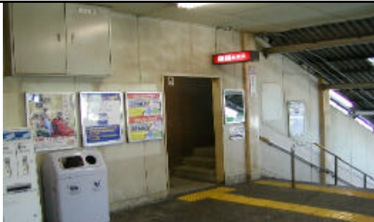
写真5 改札内コンコース便所（車椅子トイレ未整備）
