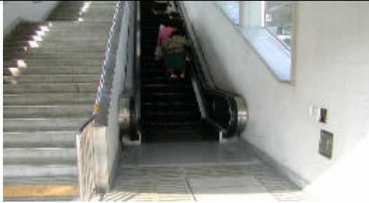
写真1 駅広場エスカレーター（インター有）
