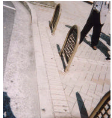
3-2 誘導ブロックと車止め 誘導ブロックが車止めにぶつかっている。
