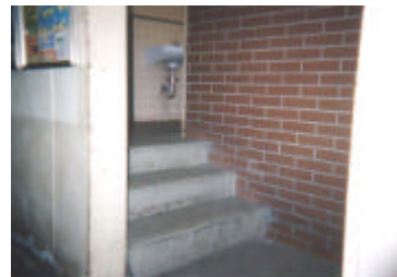
7-3 南海駅便所の階段 段差を生じている。
