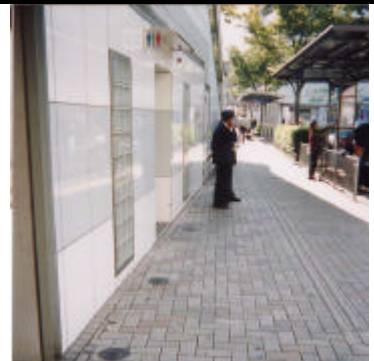
3-1 トイレ入口へ誘導ブロックが未整備 誘導ブロックが連続していない。
