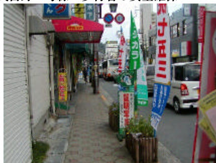
A.国道170号 幅員不足の歩道、障害物の看板等
