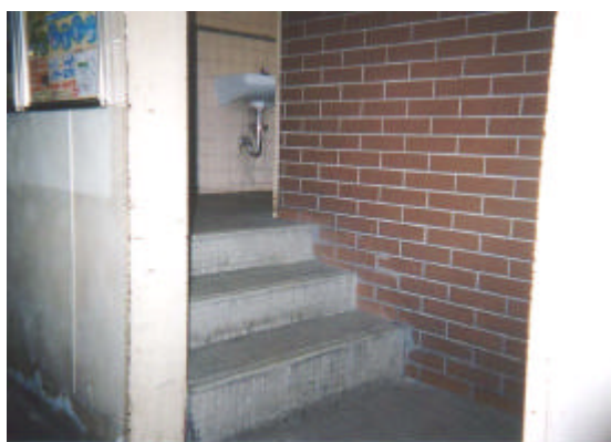
南海駅トイレの階段 段差を生じている
