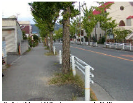
E. 野作向野線 誘導ブロックの未整備
