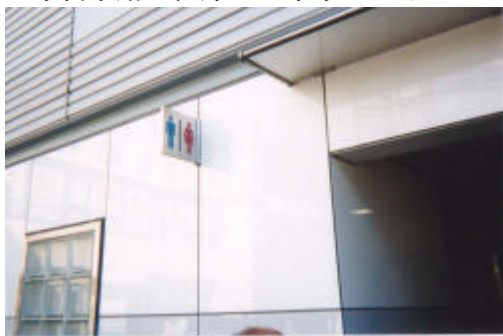
駅前広場のトイレサイン サインが小さいため見にくい
