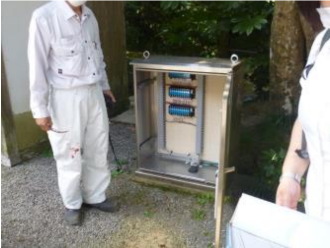
第57図 防災（消防を含む）設備の定期点検
