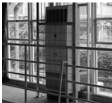
箕面市の体育館エアコン
