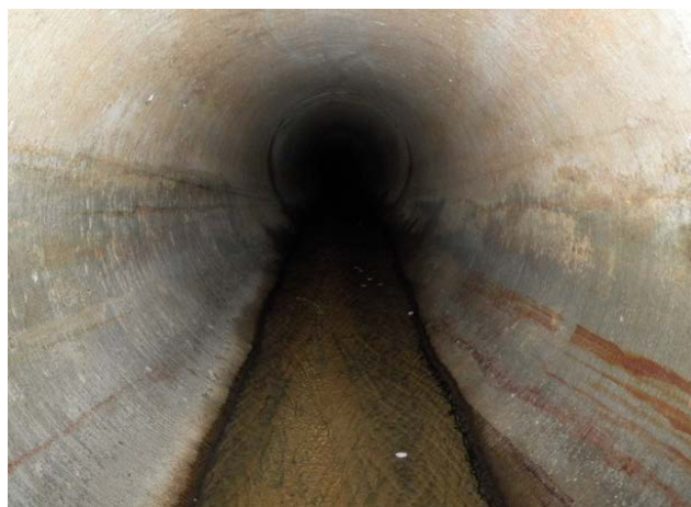
写真 1.4 雨水管（大師町内）
