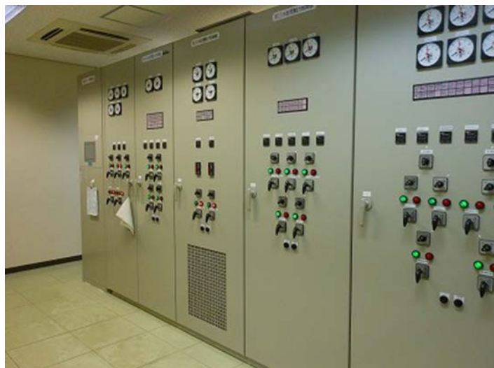
写真 5.3 滝畑浄化センターの電気室
