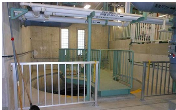
写真 5.2 滝畑浄化センターの水処理施設
