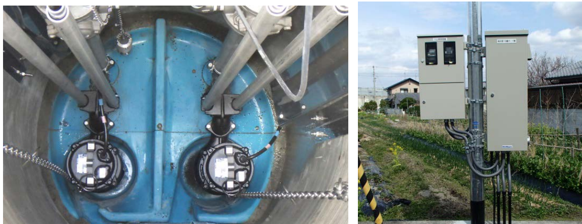
写真 1.5 マンホール形式中継ポンプ場の槽内と制御盤
