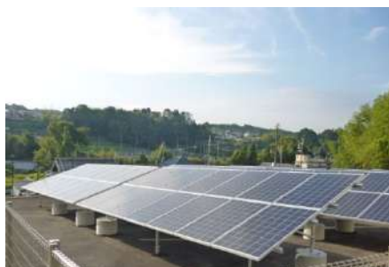
水道施設である日野加圧ポンプ室敷地内に設置した太陽光パネル
