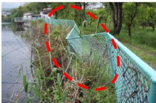
ネットフェンスの転倒
