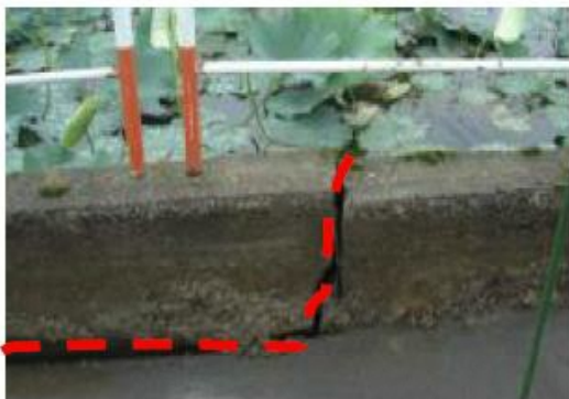
基礎ブロックの破損
