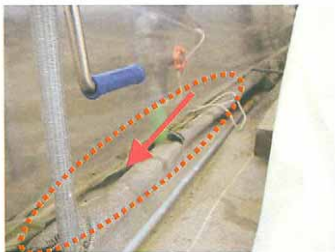
写真-17 側面カーテンの裾部の隙間
