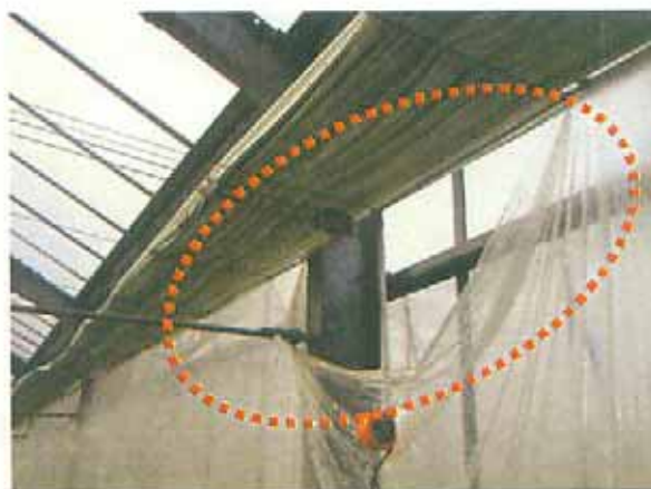
写真-1 4 肩部垂れ下り隙間
