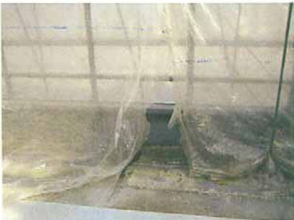
写真－9 内張カーテンの破れ1
