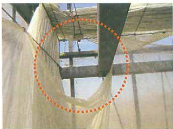
写真-1 3 温室コーナー部分の隙間
