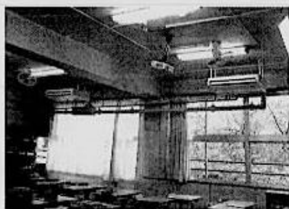
昨年設置された中学校のエアコン 今年は小学校に設置されました
