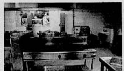
富田林市立明治池中学校の給食調理室
