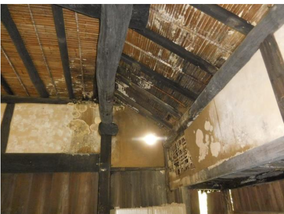
雨漏れによる簀子天井、土壁の破損状況
