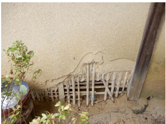
湿気による土壁の破損状況
