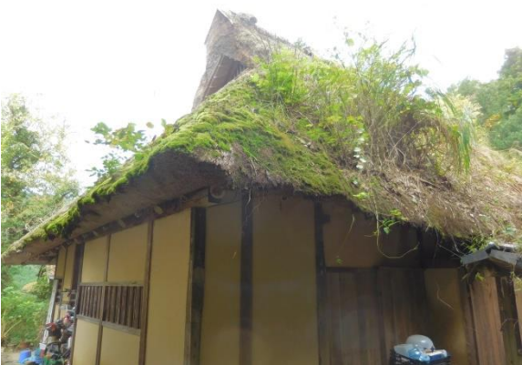
経年による茅葺屋根の破損状況
