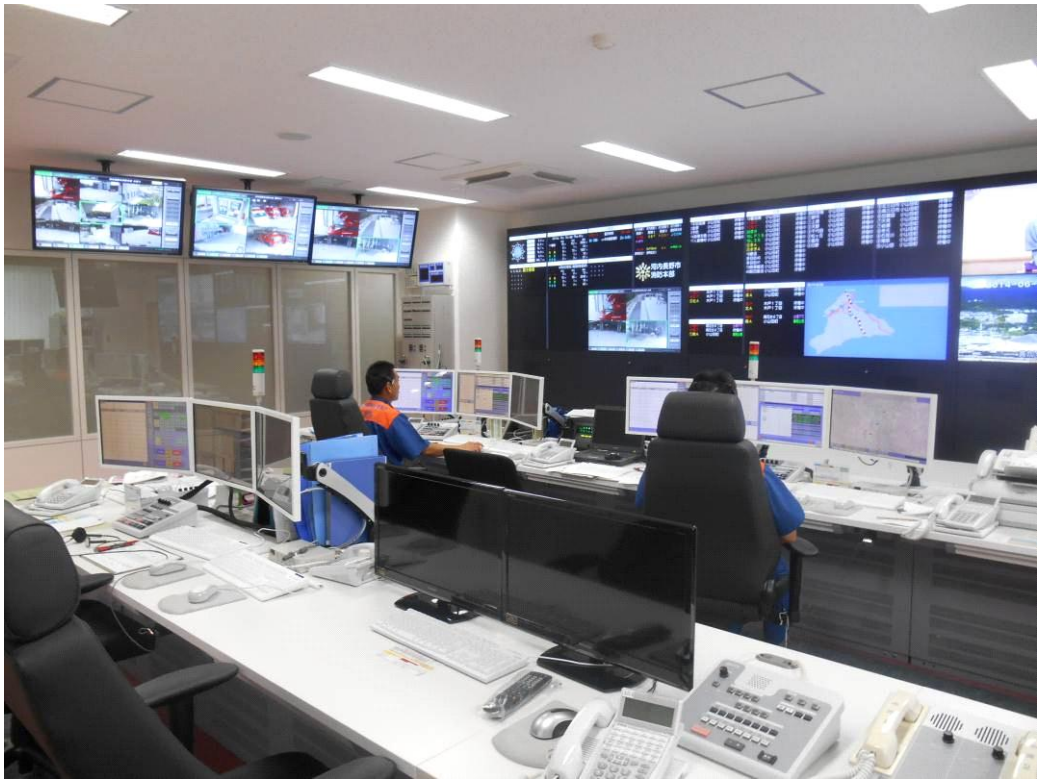
平成 2 5 年度に更新した高機能消防指令センター
