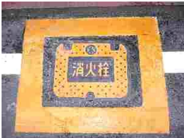
道路上にある消火栓の蓋の周囲に黄色塗装
